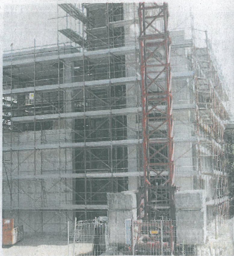
Cantiere deserto: molti lavori edili non sono stati completati. OSKARPRESS
